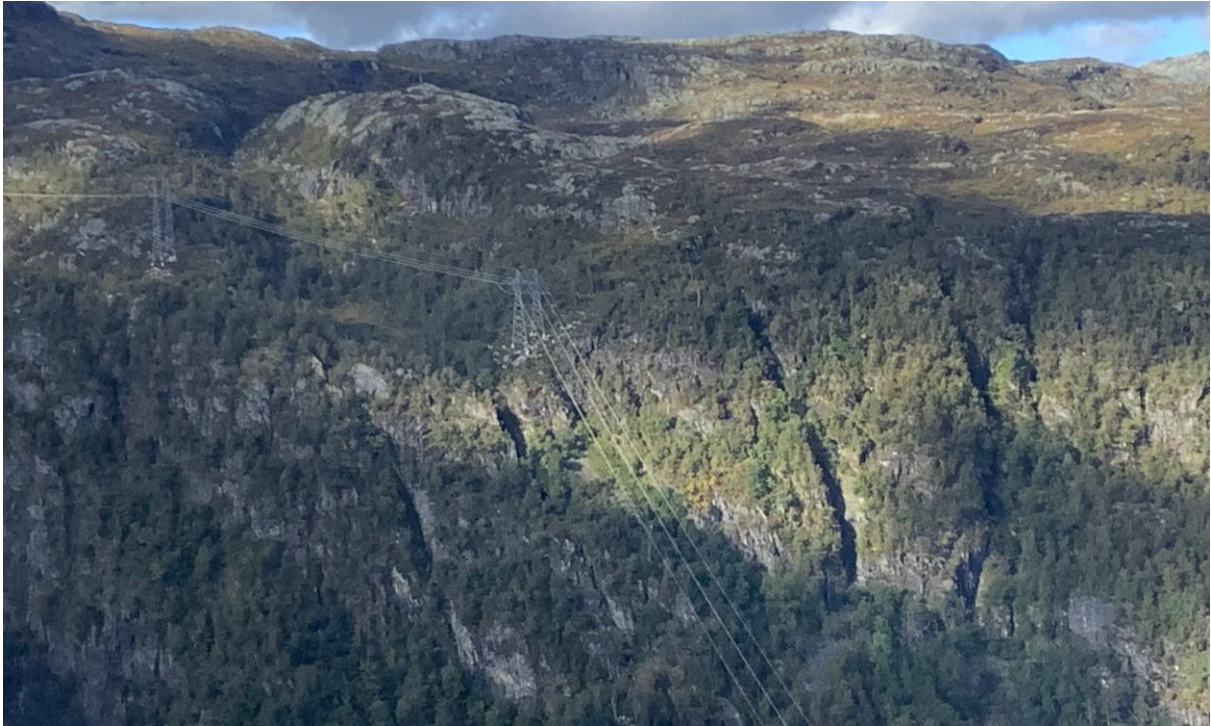
Figur 6. Høyspentmaster på nordsiden av Hylsdalen. Masten midt i bildet er den hvor det var mest erosjonsskader rundt.
