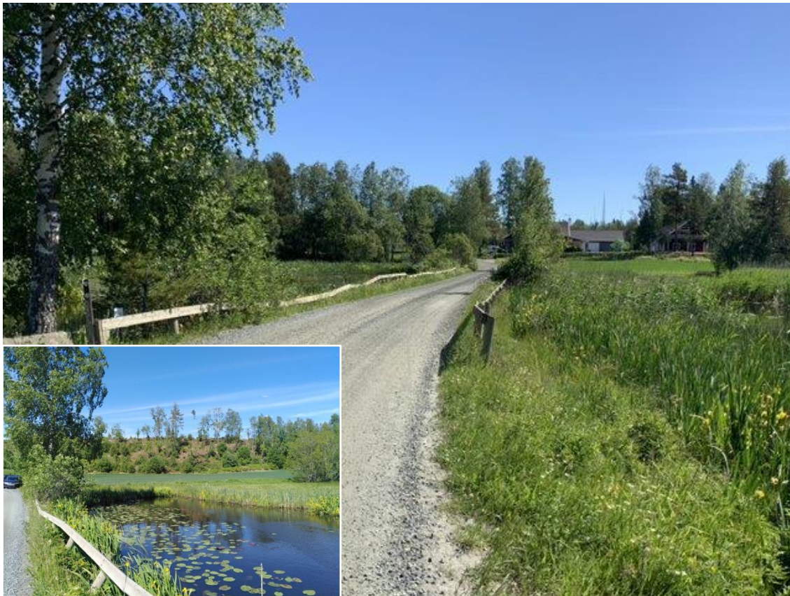
Figur 16. Veifyllingen begrenser vannutbytte mellom bassengene. En større kulvert eller bru vil trolig bedre flomproblemene i sør (Foto: M. Nygård og L. Hoch 2020)
